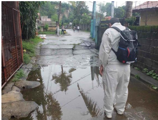
図 1 断層クリープによる道路破損
