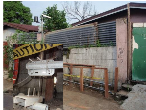
図 2 固定観測点の概観とセンサの設置状況
