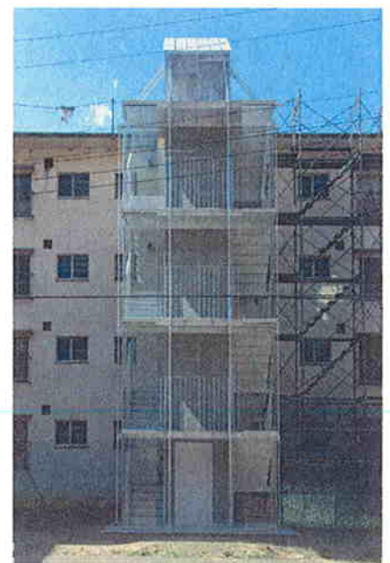
本研究プログラムにおいて建設した 団地型集合住宅増設用エレベーター
